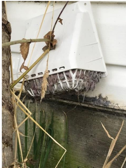
Plugged drier vent
